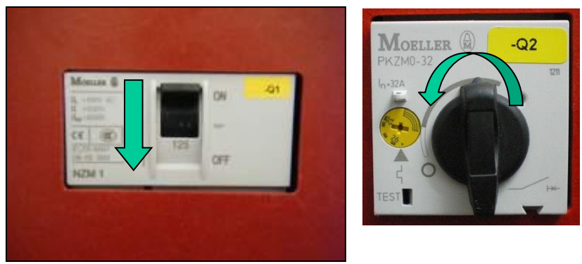
図3-2. ブレーカーOFF (写真はON時)
